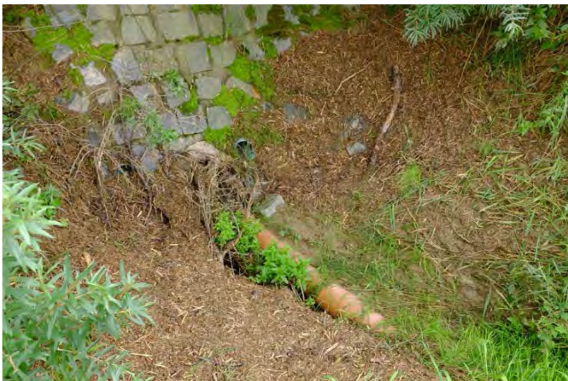
Abb. 53: Teilweise verstopfter Durchlass an der Straßenböschung, Foto 10.08.2016
