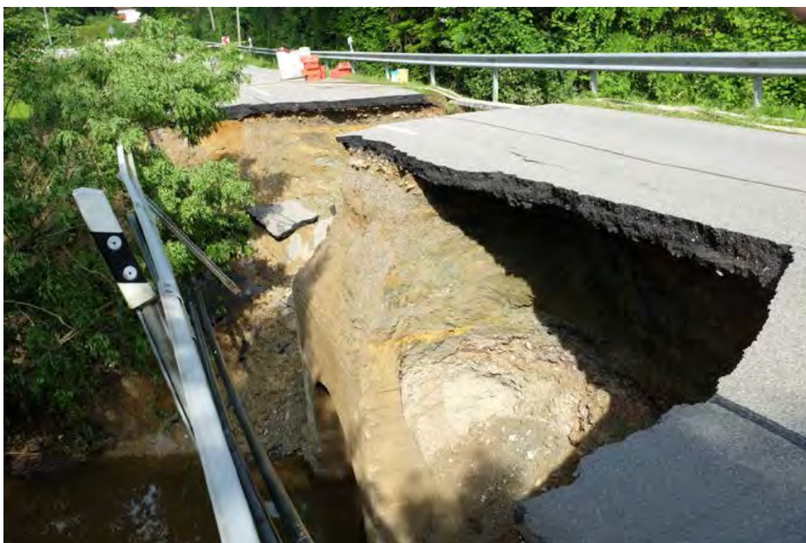
Abb. 63: Zerstörte Straßenbrücke, Fließrichtung nach links, Foto 03.06.2016
