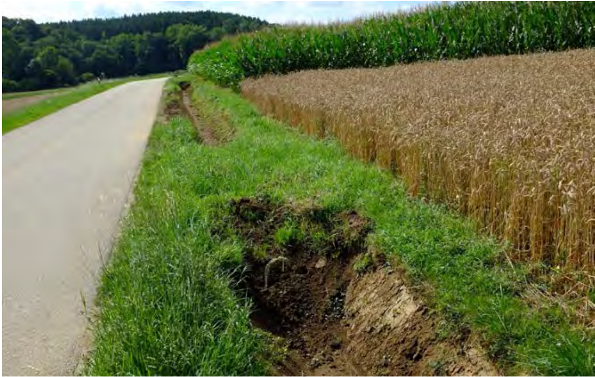
Abb. 86: Unterhalb des Maisfeldes aus Abb. 84 im August, Graben geräumt, Durchlässe weiterhin mit Bodenmaterial verstopft, Foto 01.08.2016
