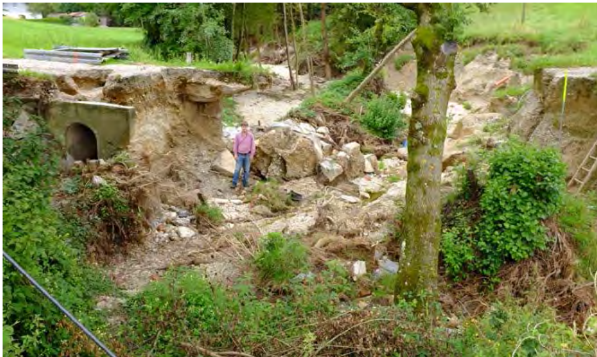
Abb. 58: Zerstörte Überfahrt (Hofzufahrt) und ausgeräumtes Bachbett, Situation am 10.08.2016, Einzugsgebiet Simbach
